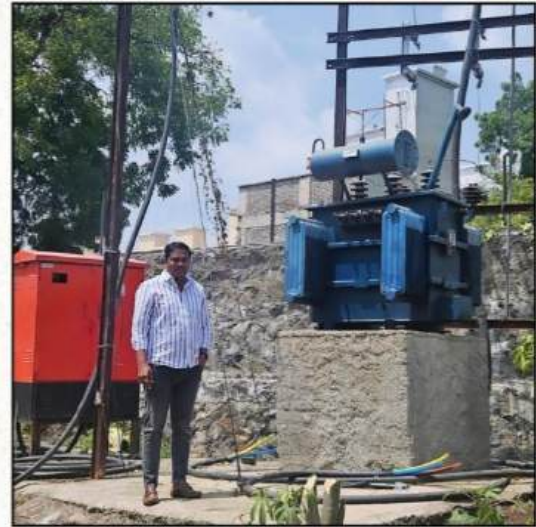
गणेश नगर भागात 315 kv चा ट्रान्सफॉर्मर बसवला
