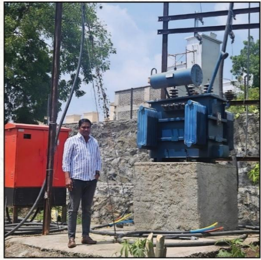
गणेश नगर भागात 315 kv चा ट्रान्सफॉर्मर बसवला
